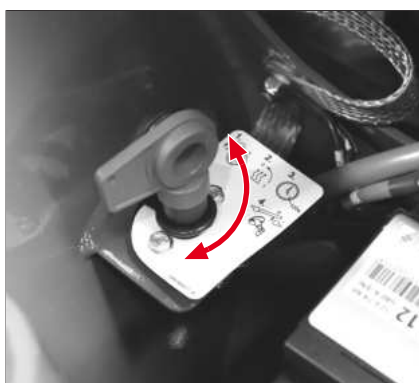
Abb. 98: Lage des Batterietrennschalters
